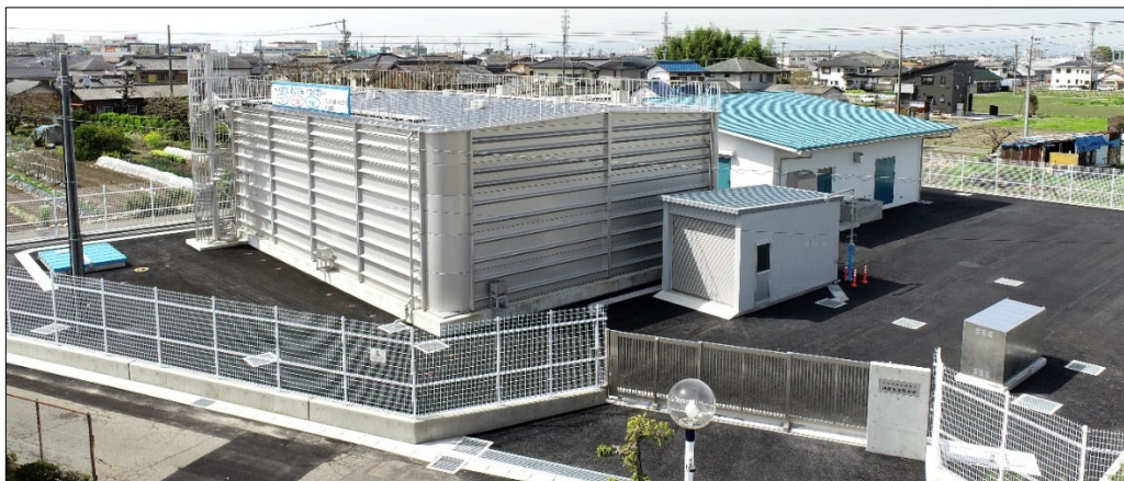
【扶桑北部配水場】
